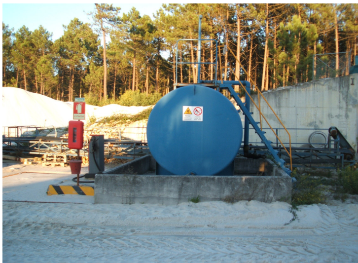
Fotografia 3.3.1 – Vista do tanque de combustível.
