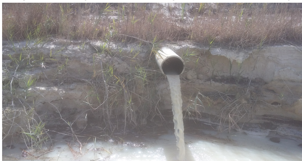
Fotografia 3.1.1 – Água libertada para a lagoa a partir de bacia de retenção.
